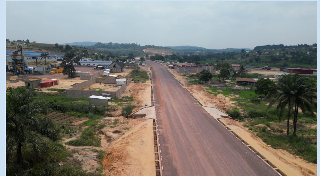
RSE : Etat moyen de la route (couche de base)
